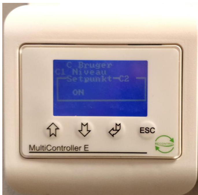
C2 skal stå på ON
